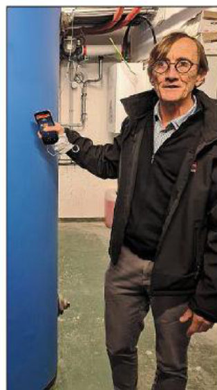
Raphaël Petit, dirigeant de E 2 solaire, devant le ballon d'eau chauffé par les panneaux solaires, dont il est l'installateur.
