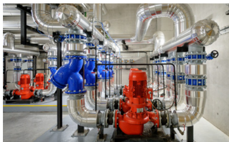
Une chaufferie biomasse
