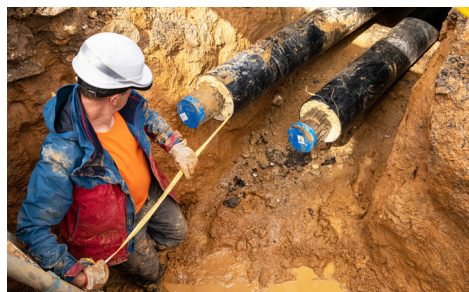
Entretien-maintenance des réseaux
